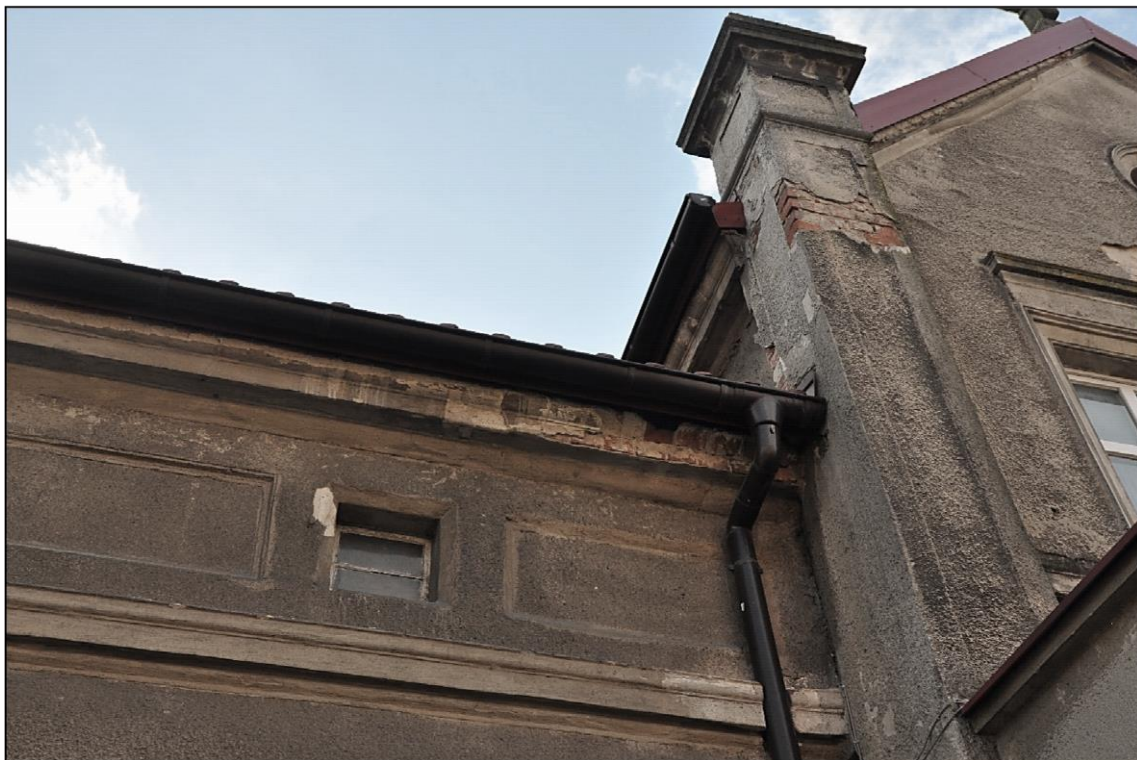
Fot.2. Budynek: dawnej pastorówki przy ul. 3 Maja 9. Górny fragment ryzalitu w osi głównej fasady. Widoczny stan zachowania tynków: rozległe złuszczenia tynku do ceglanego wątku. Całość elewacji pokryta szarym tynkiem nakrapianym z lat 80-tych XX w.
