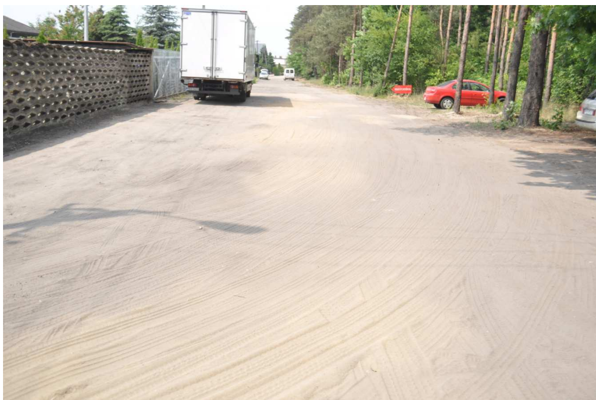
Stan istniejący nawierzchni ulicy Rzemieślniczej w Bralinie
