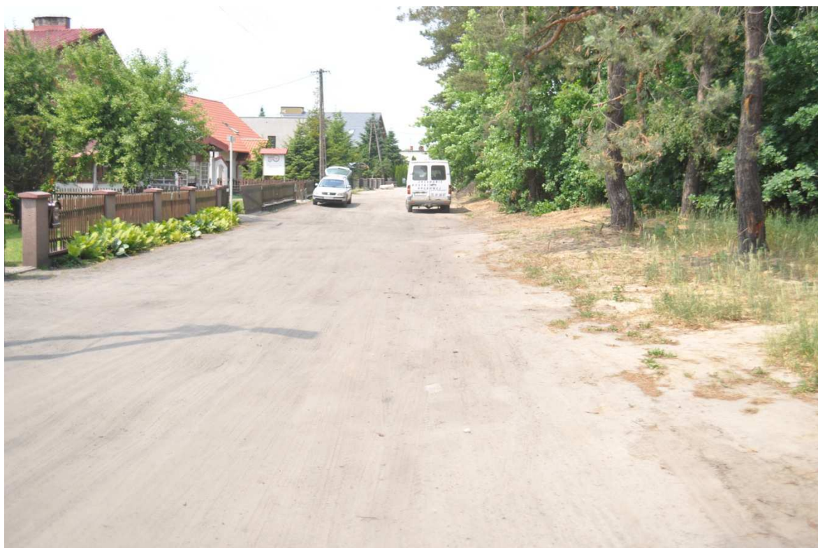
Stan istniejący nawierzchni ulicy Rzemieślniczej w Bralinie
