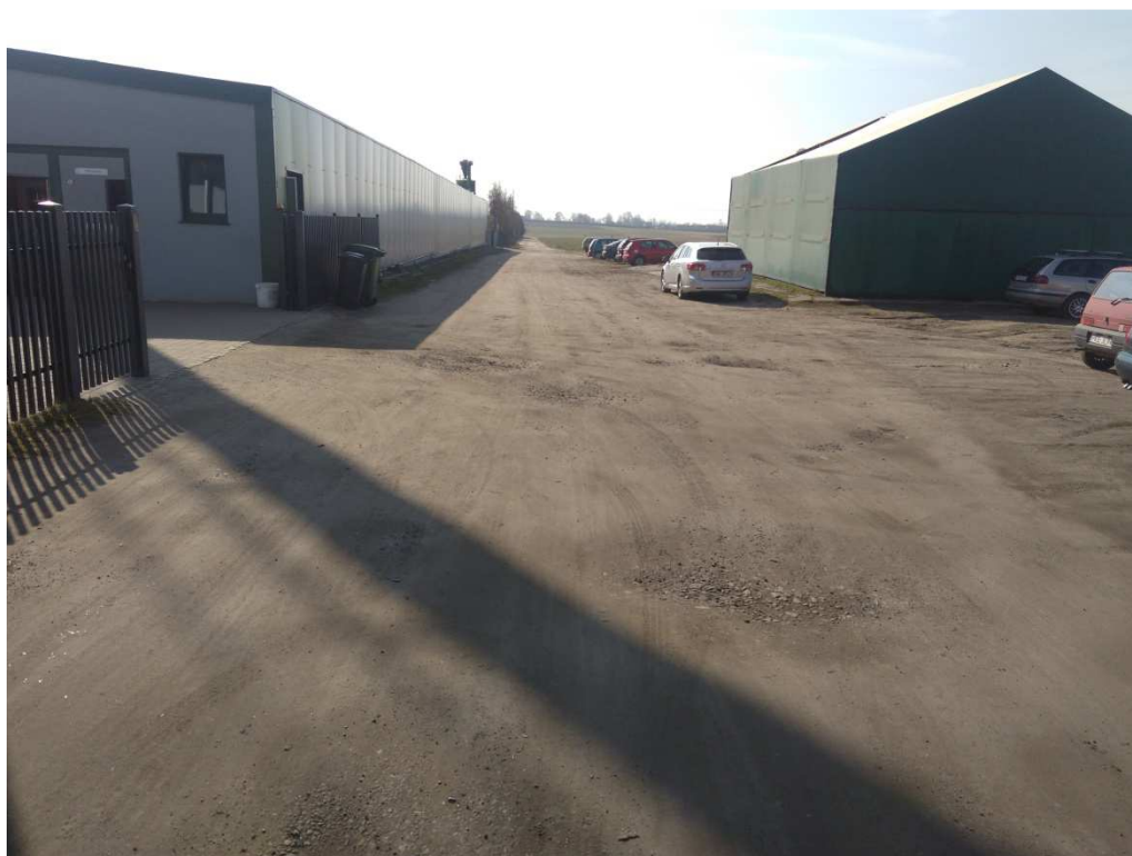
Stan istniejący nawierzchni
